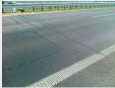
Stanowisko pomiarowe z wbudowanymi pętłami indukcyjnymi
